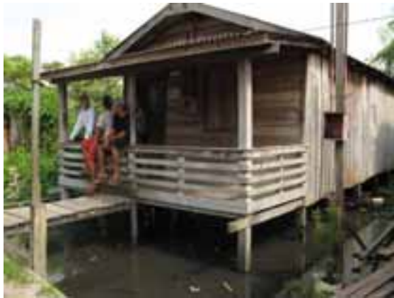
Eau stagnante, sous une maison.
